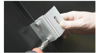
C. Flytta klämma till önskad position på fals och drag åt M8. Åtdragningsmoment 8-10 Nm
