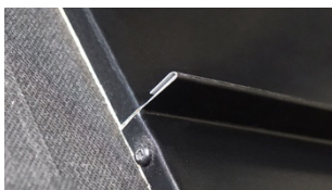
A. Notera falsomslag på takplåt.
